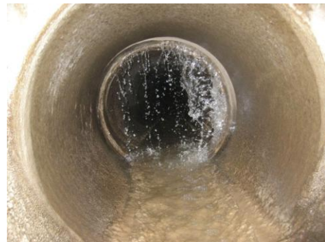
Eindringendes Grundwasser durch undichte Rohrverbindung
